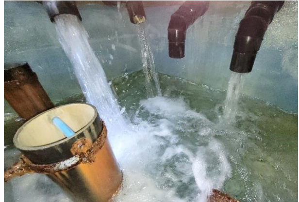
Bild 7: Sammelbecken der Quellschächte mit Überlaufstrümpfel
