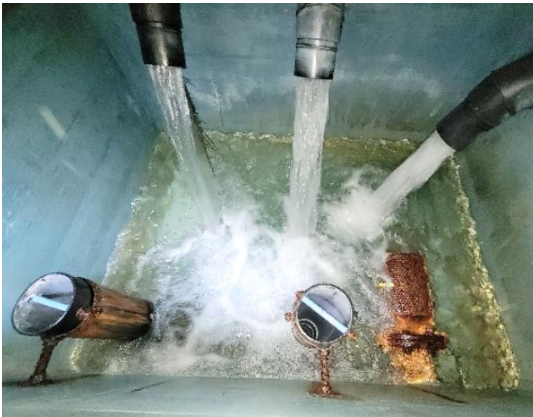
Bild 6: Sammelbecken der Quellschächte
