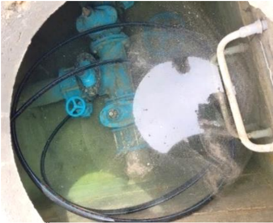
Bild 12: Überfluteter Schacht 3045a
