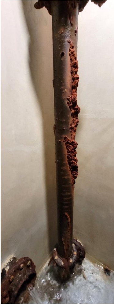
Bild 3: Überlauf in Wasserkammer
